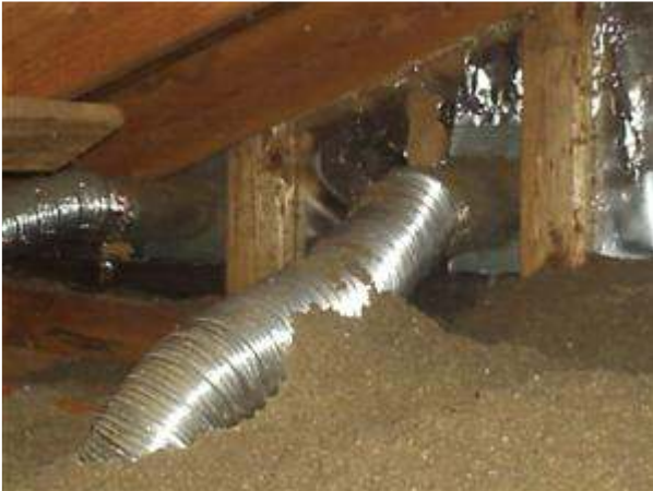
6.3 Picture 1 fan vents
